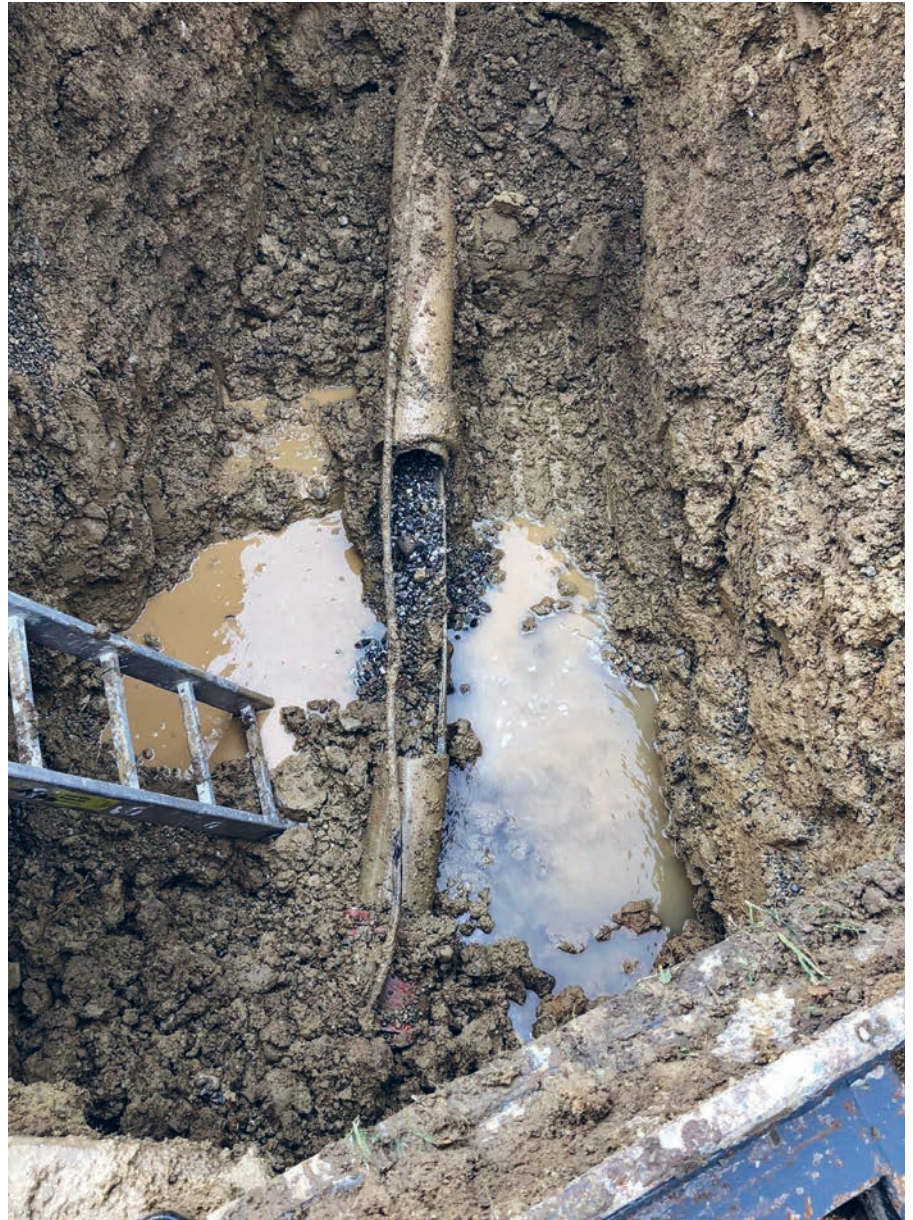
Die defekte Wasserleitung beim Reservoir Bergäcker
