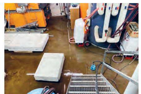
Wasserschaden Fernwärmeheizung Talacker.
