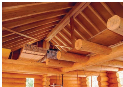
Blick vom ersten Stock auf die Dachkonstruktion. Alles passgenau auf den Millimeter.
